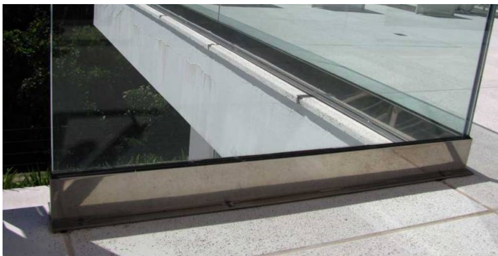
Figura 1: exemplo da canaleta em aço a ser utilizada na execução do guarda corpo.
